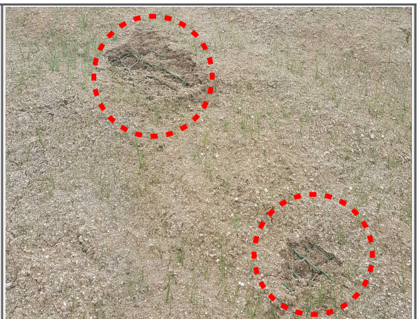
④ Sta.0+700부근(영천) 1소단 하부 부작망의 노출
